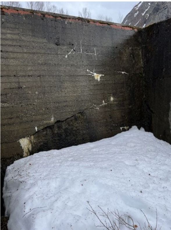
Bilde 2: Bilde viser synlige sprekker i dammen.
