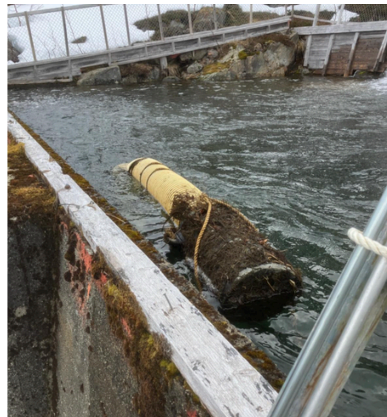
Inntaksrør i Nuvsvåg tilstoppet av rusk og løv under vårfloppen 27.05.25
