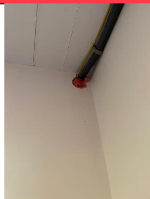
Bilde 38. Det ble stedvis observert fugeskum som kan inneholde KFK-gass
