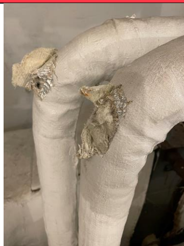
Bilde 4. Det ble kun påvist asbest i isolasjonsmateriale rundt rørbend (prøve L23)
