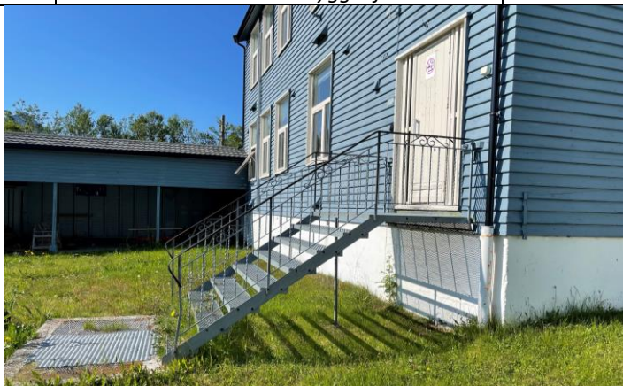
Bilde 37. Håndløper på trapp til inngangsdør er av PVS og inneholder ftalater
