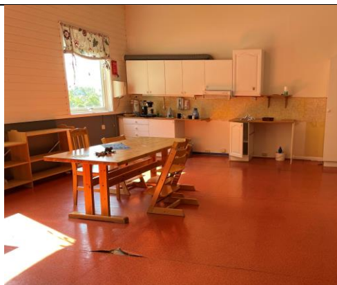
Bilde 35. Vinylbelegg på vegg i 2. etasje av tilbygget håndteres som farlig avfall med ftalater. Gulvbelegget av linoleum kan håndteres som ordinært byggavfall
