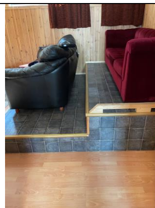
Bilde 36. Vinylbelegg på trappepodie i 1. etasje av tilbygget håndteres som farlig avfall med ftalater
